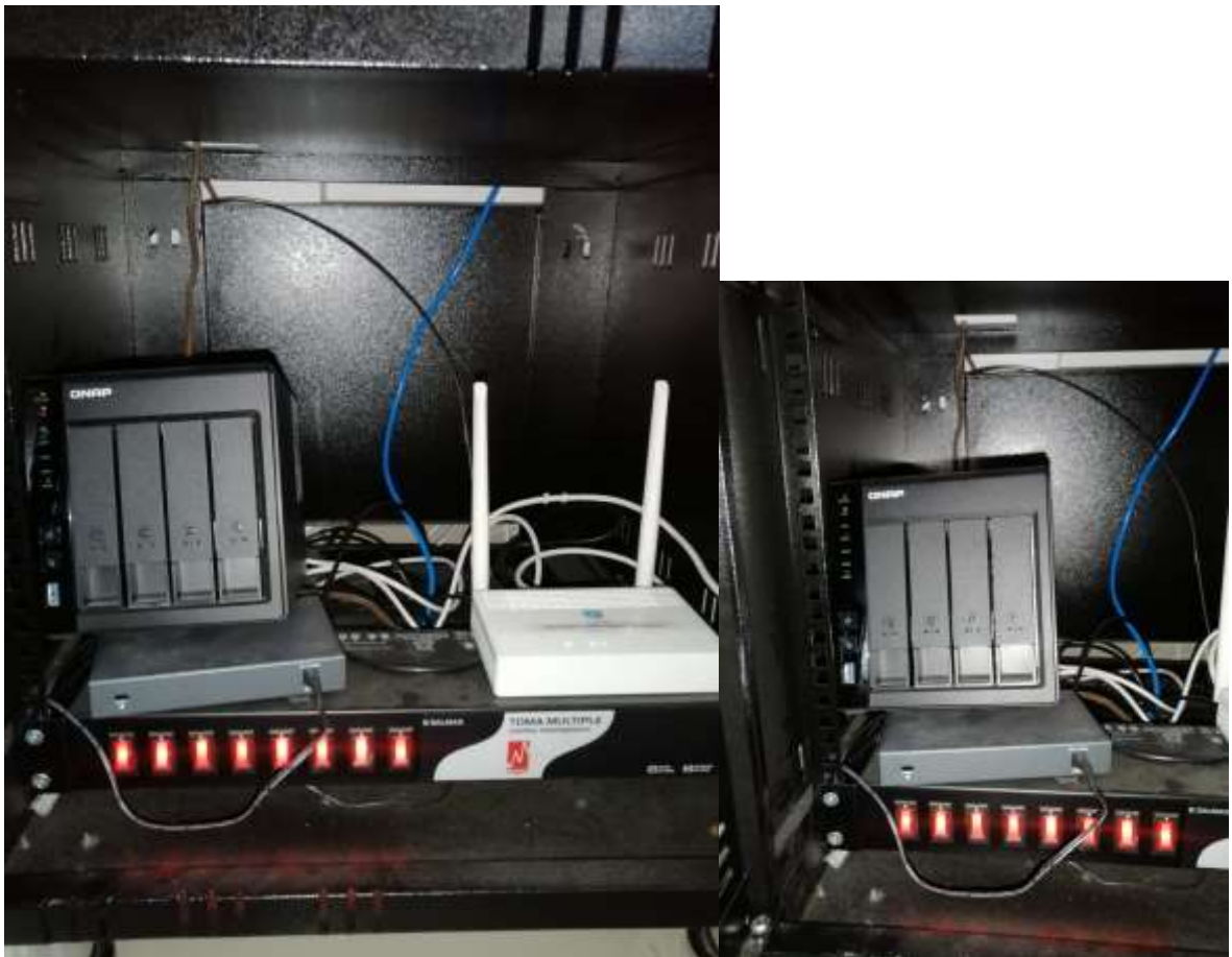
Ilustración 6 Fotografía del servidor NAS de la empresa Ingeniería STM
