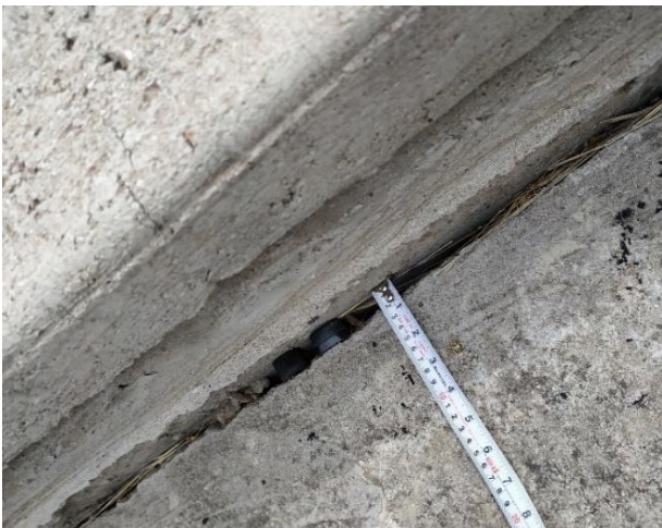
Figura 21. Grietas en el muro actual.
