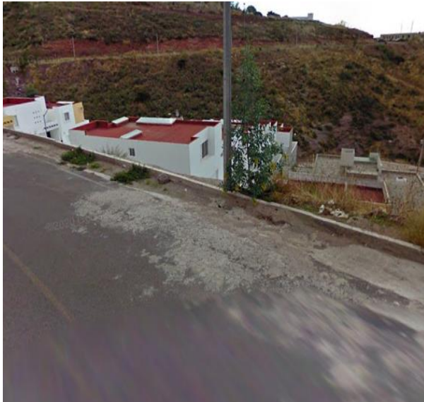
Figura 17. Caída de guarnición
