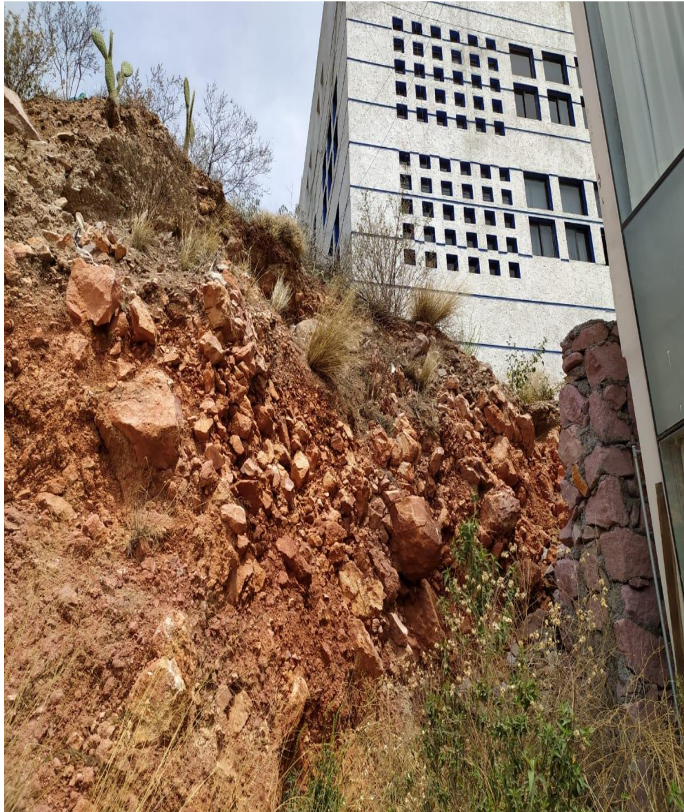
Figura 39. Derrame riolítico y muro contención margen occidental del Campus universitario.
