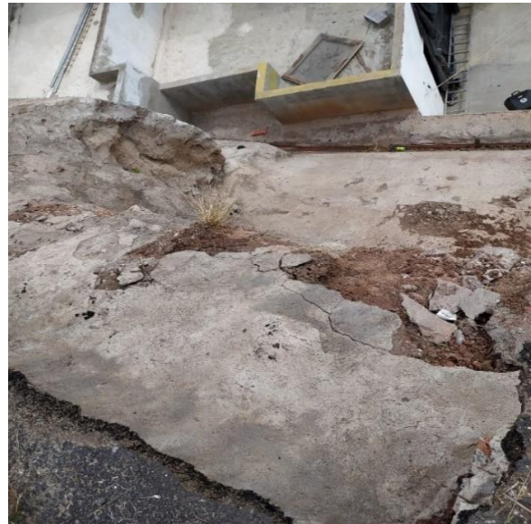
Figura 16. Caída de guarnición
