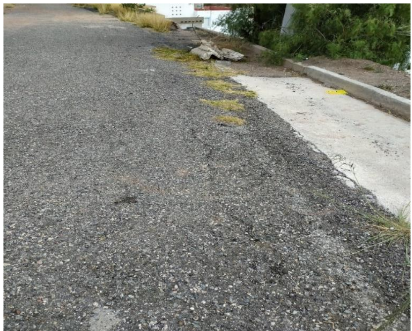
Figura 15. Grietas y desgastamiento en la vía.
