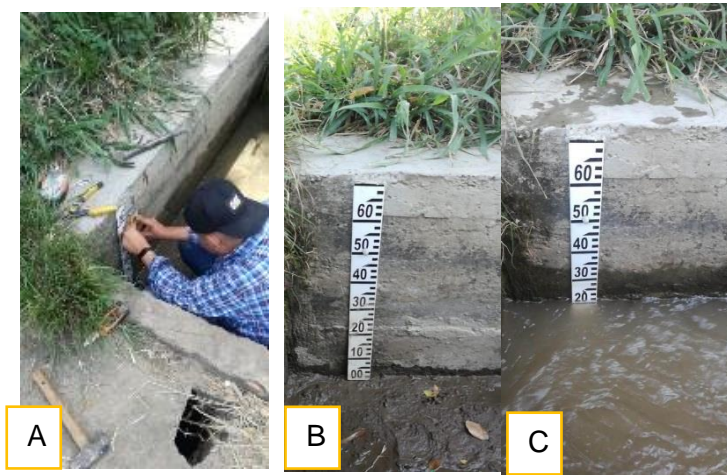
Figura 6: Instalación de la regleta(A) Asegurando la regleta (B) Regleta Compuerta cerrada (C) Regleta compuerta Abierta
