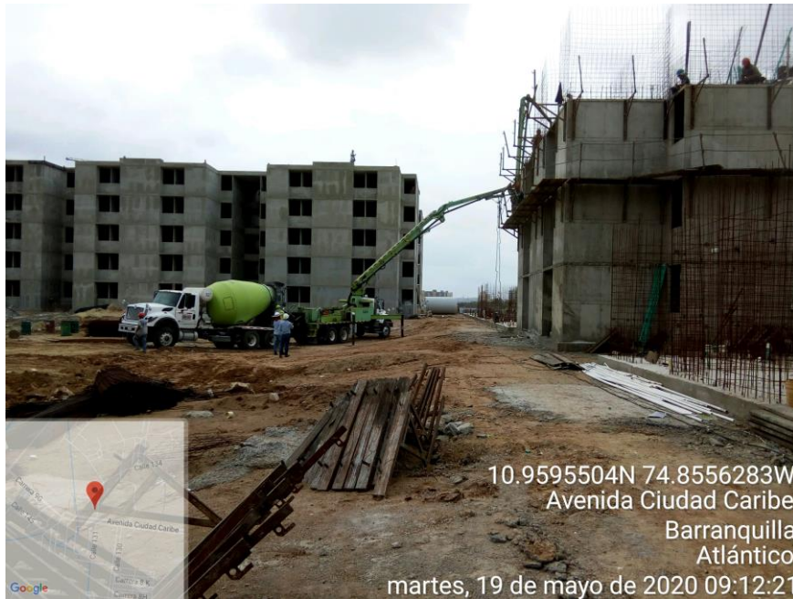
Figura 15. Bombeo de la mezcla hacia los muros de los apartamentos (Fuente propia)
