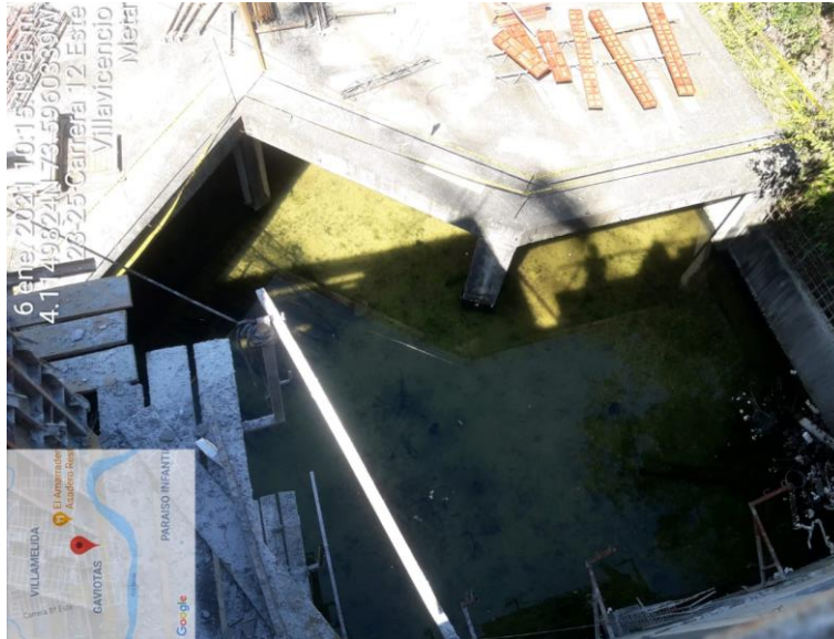
Ilustración 25 Evacuación del agua del sótano. (Fuente propia)
