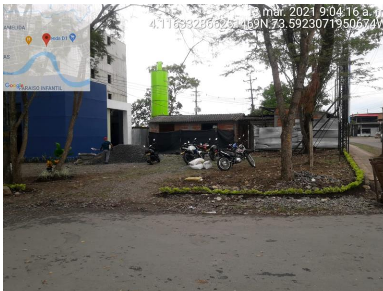
Ilustración 26 Embellecimiento y cerramiento de zona contigua a sala de ventas. (Fuente propia)
