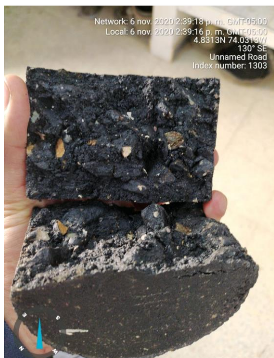
Figura 84. Daño por humedad visual.
