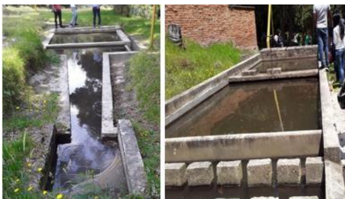
Fotografía 3. Desarenadores planta Cariongo Fuente: Gelvez (2020)
