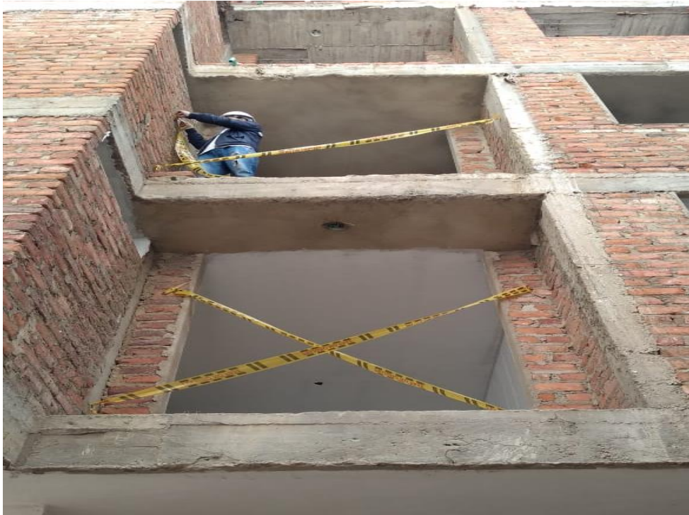
Figura 8: Demarcación de zonas de peligro.
