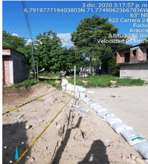
Ilustración 41: Señalización (cinta peligro). Sarmiento Gonzalo (2020)
