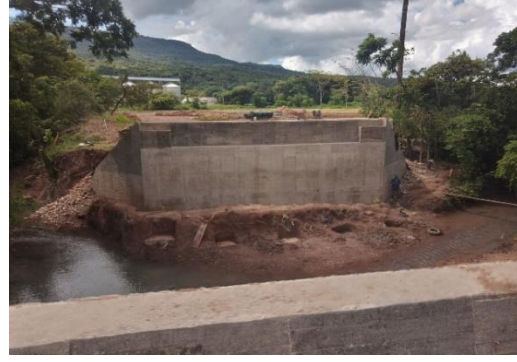
Ilustración 39. culminación de Muros o elevaciones estribos, concreto para puente de resistencia 3000 Psi.
