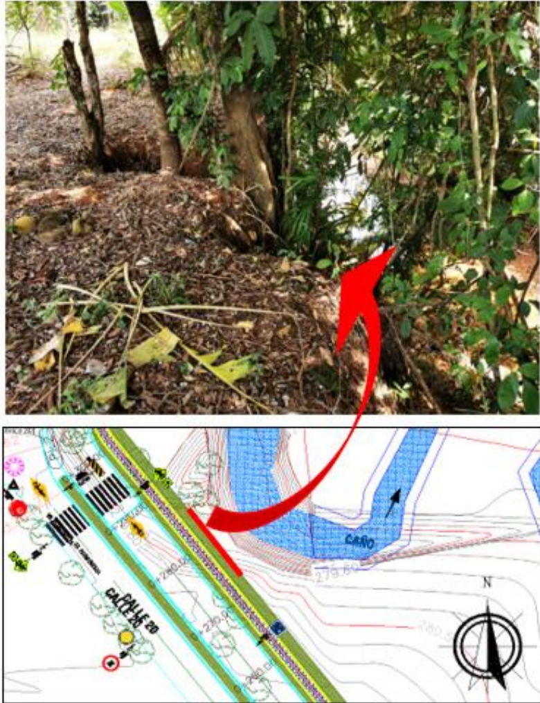
Ilustración 93. Localización en planta del área sin protección de la estructura vial.
