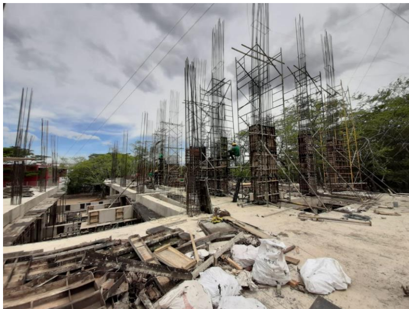
Figura 22. Estado ultimo de Columnas de la segunda placa. Proyecto Aulas Orientales Fase II.
