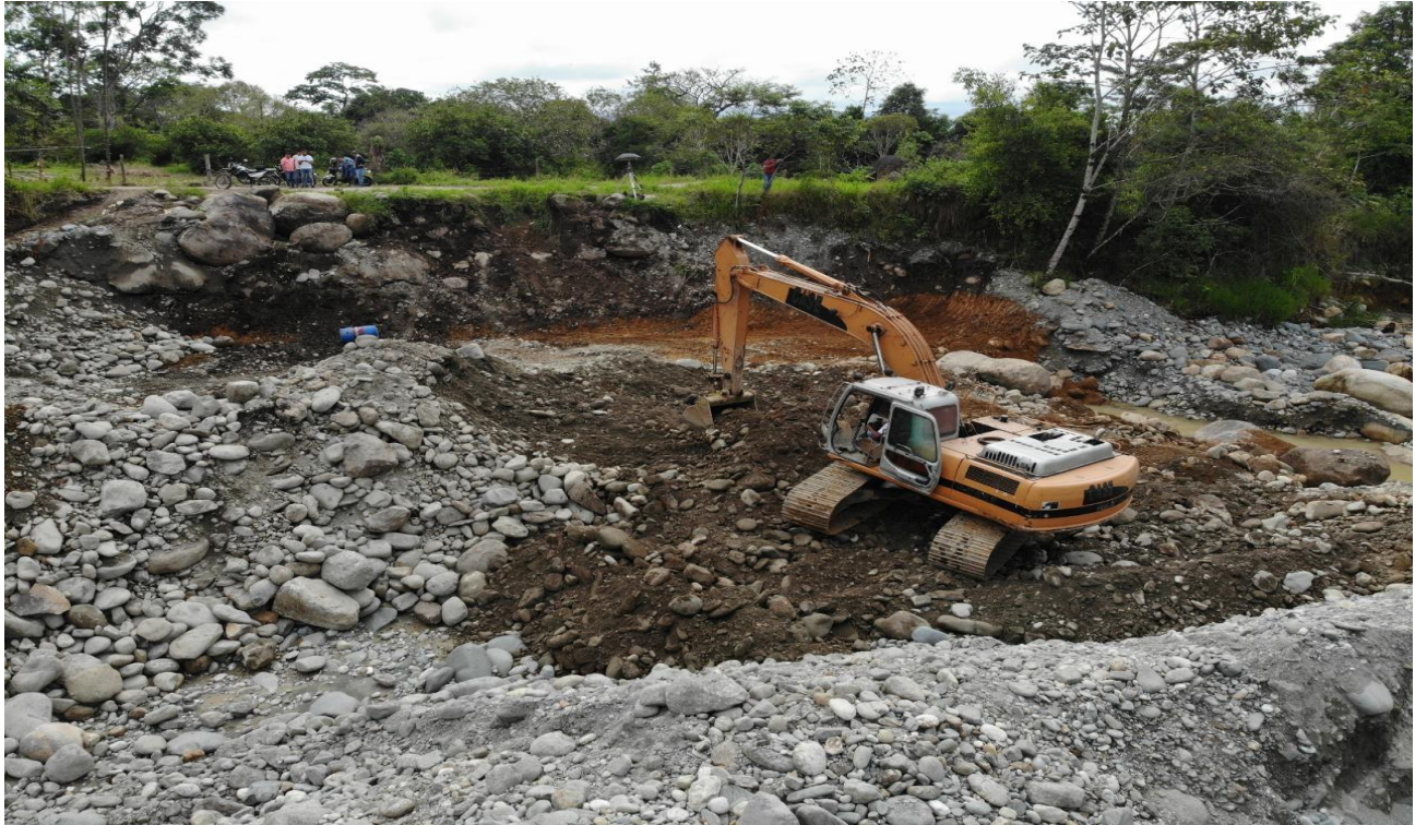
Ilustración 24. Canalización del Rio Lucia
