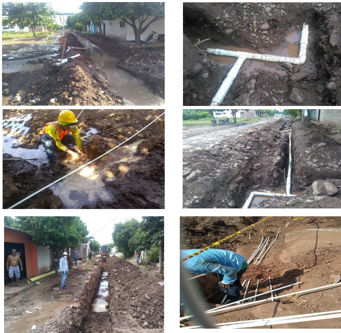
Ilustración 27. Reparaciones de tubería red hidráulica y condiciones del clima. Fuente: elaboración propia por el autor.
