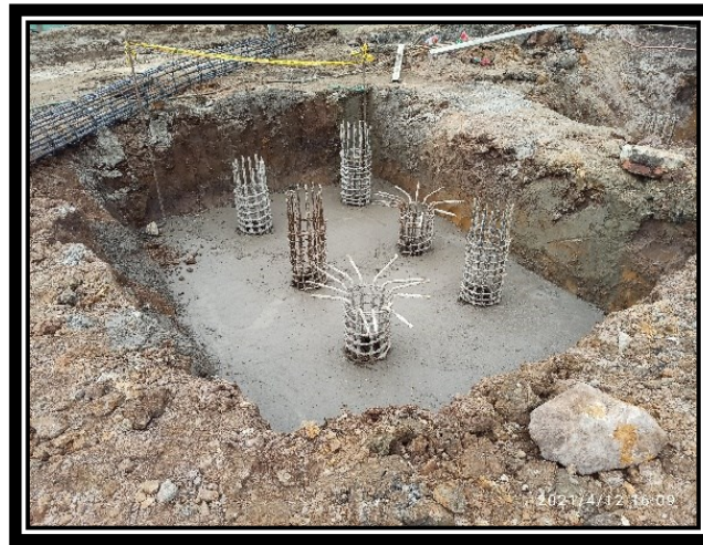
Ilustración 26 Muestra de saneamiento de cabezal GP4 en el eje G2
