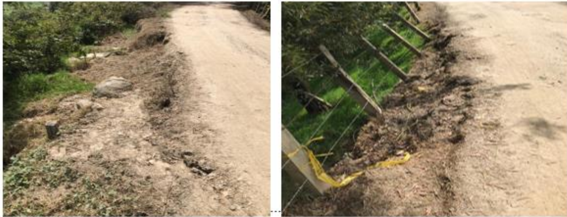
Ilustración 11 afectación del lugar a construir los gaviones.
