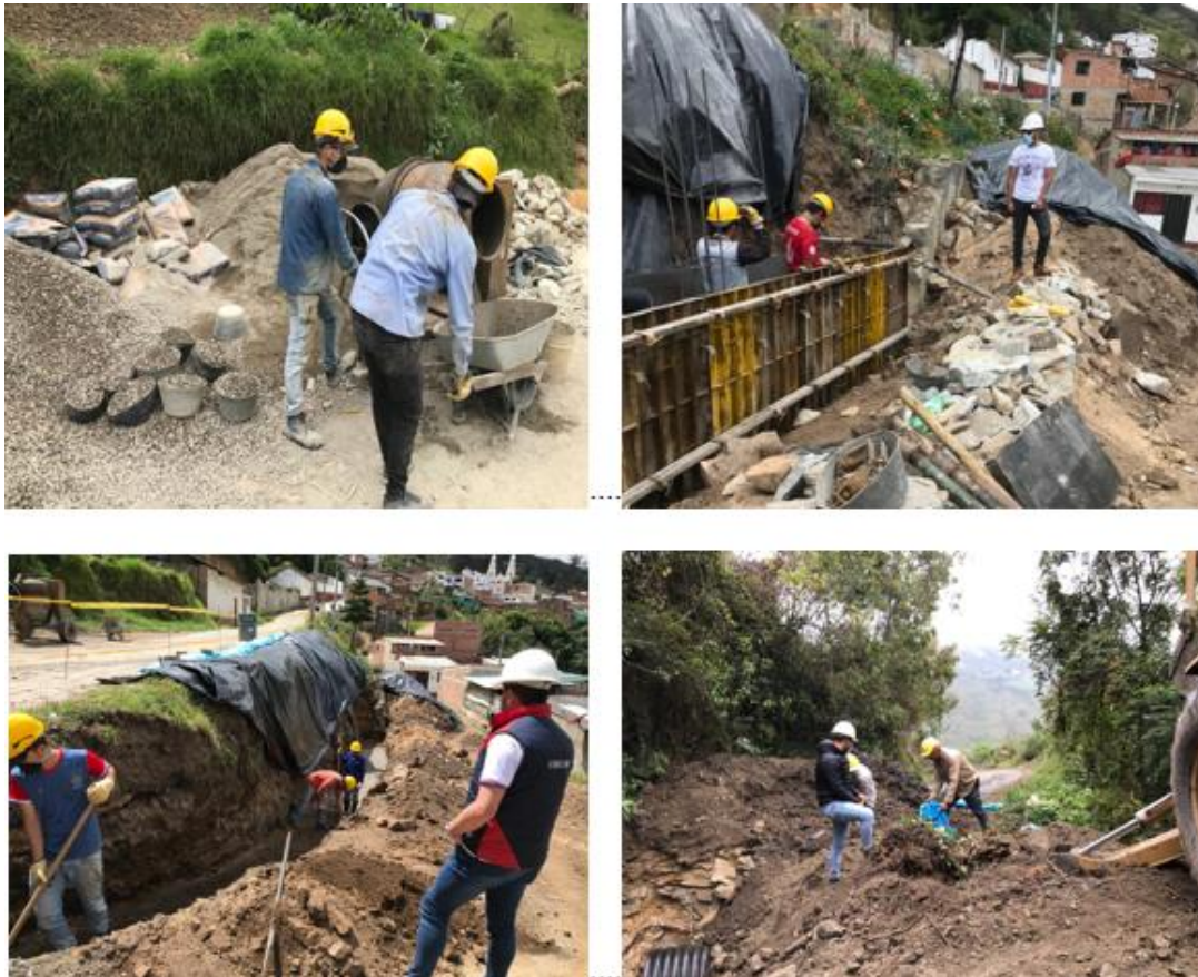
Ilustración 38 verificación de dotación de seguridad.
