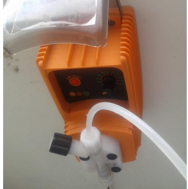
Vista general de una electro-bomba
