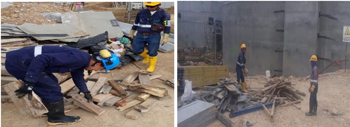
Imagen 23. Jornada de orden y aseo. Recolección de madera en frente de obra
