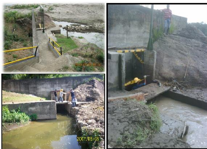
Ilustración 9 Captación Auxiliar Río Pamplonita Fuente: Aguas Kpital, 2007.
