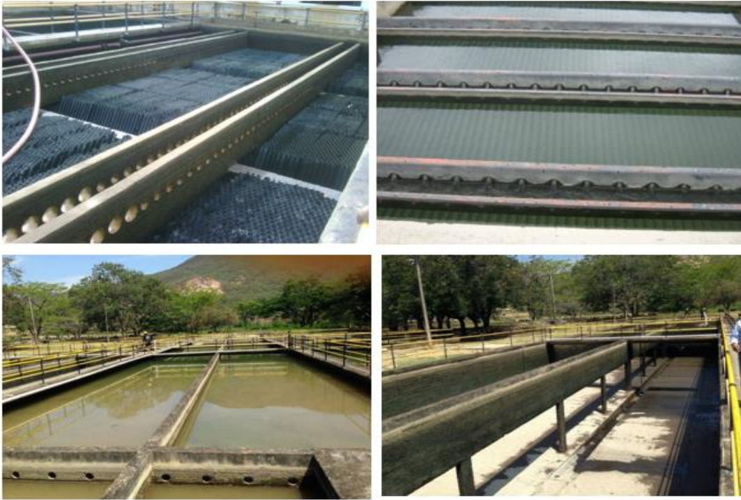
Ilustración 14 Sedimentación PTAP El Pórtico Fuente: Autor, 2018
