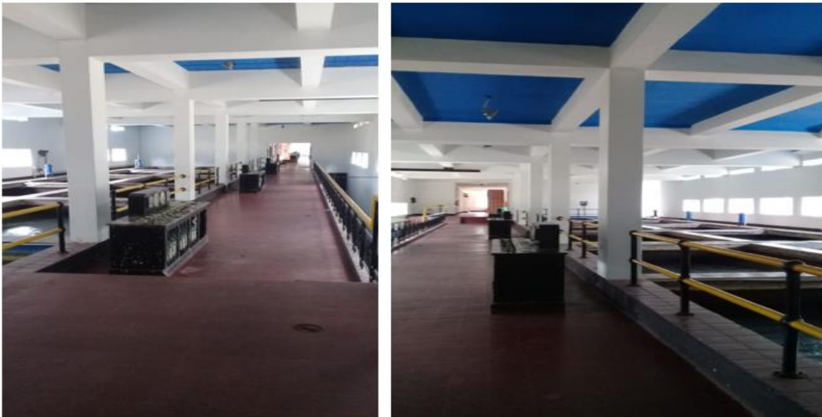
Ilustración 15 Filtración PTAP El Pórtico Fuente: Autor, 2018
