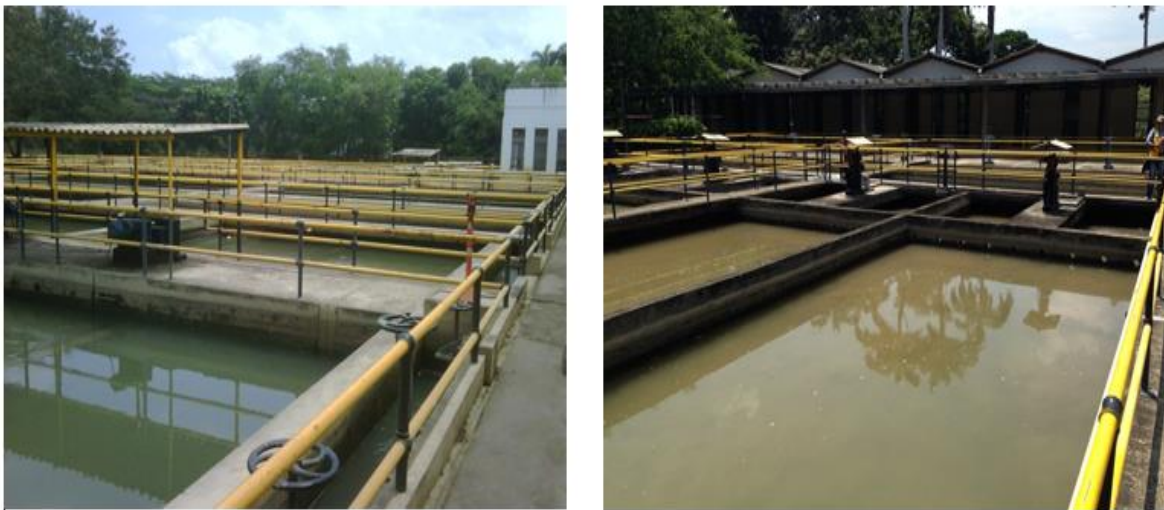
Ilustración 13 Floculación PTAP El Pórtico Fuente: Autor, 2018
