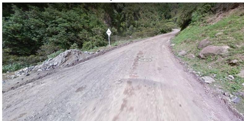
Ilustración 14.1 Estado de la vía y acceso al punto de captación de agua superficial.
