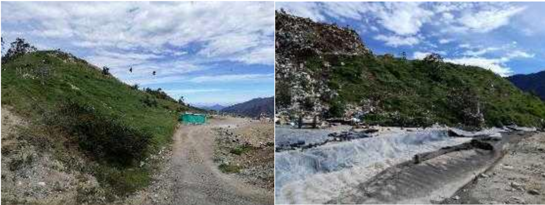
Imagen 8 Taludes de las terrazas 1, 2,3 que aún no han sido cerrados técnicamente Fuente: Angee Delgado, 2018.
