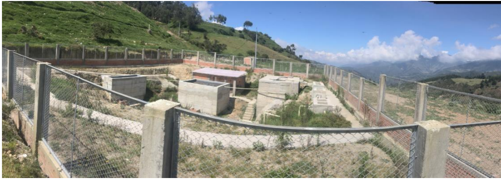
Imagen 12 Planta de Lixiviados Fuente: Angee Delgado
