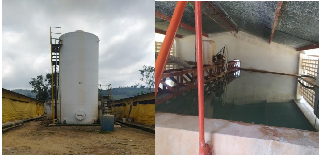
Figura 1. Tanque de almacenamiento de agua tratada y tanque de tratamiento de agua de la granja san Joaquín. Nota. Albarracín, (2020)
