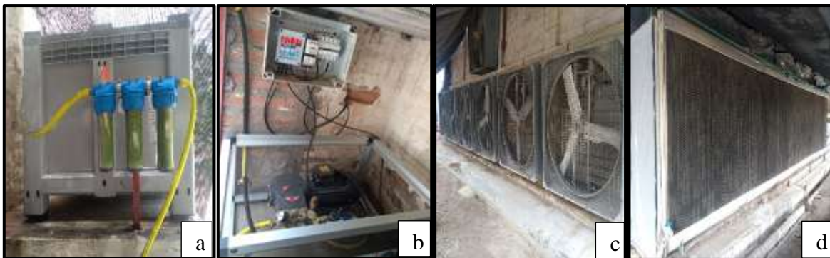
Figura 7. Área de equipos. a) Tanque de almacenamiento agua fogger, b) Bomba de los fogger, c) Extractores, d) Panel de enfriamiento.
