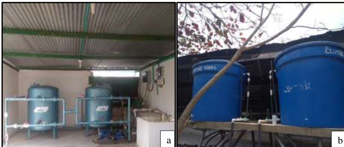
Figura 6. Área de la planta de tratamiento. a) Filtros de arena y de carbón, b) Tanques aéreos.
