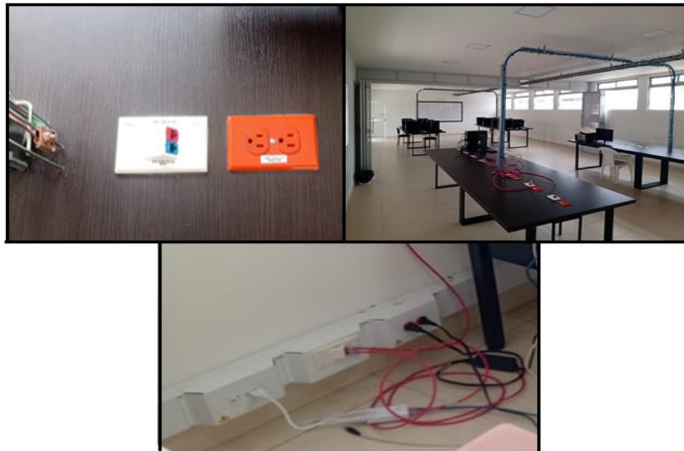
Figura 19 Tomas de Corriente & Rosetas para RJ-45
