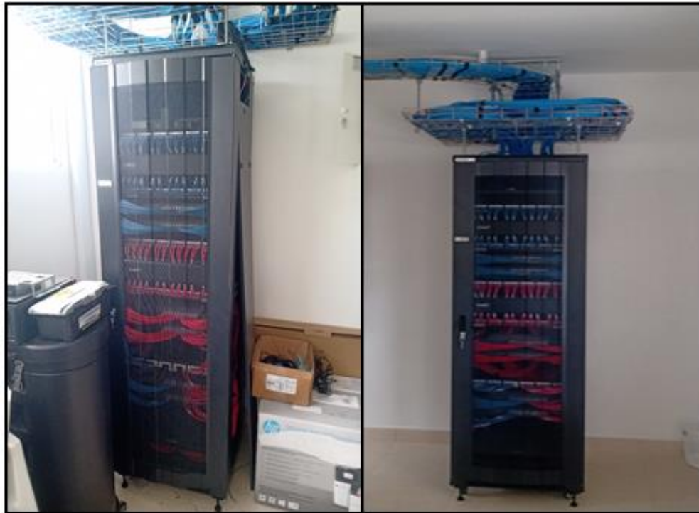
Figura 15 Racks de distribución Cuarto de Telecomunicaciones Bloque Humberto Jaimes Palacios
