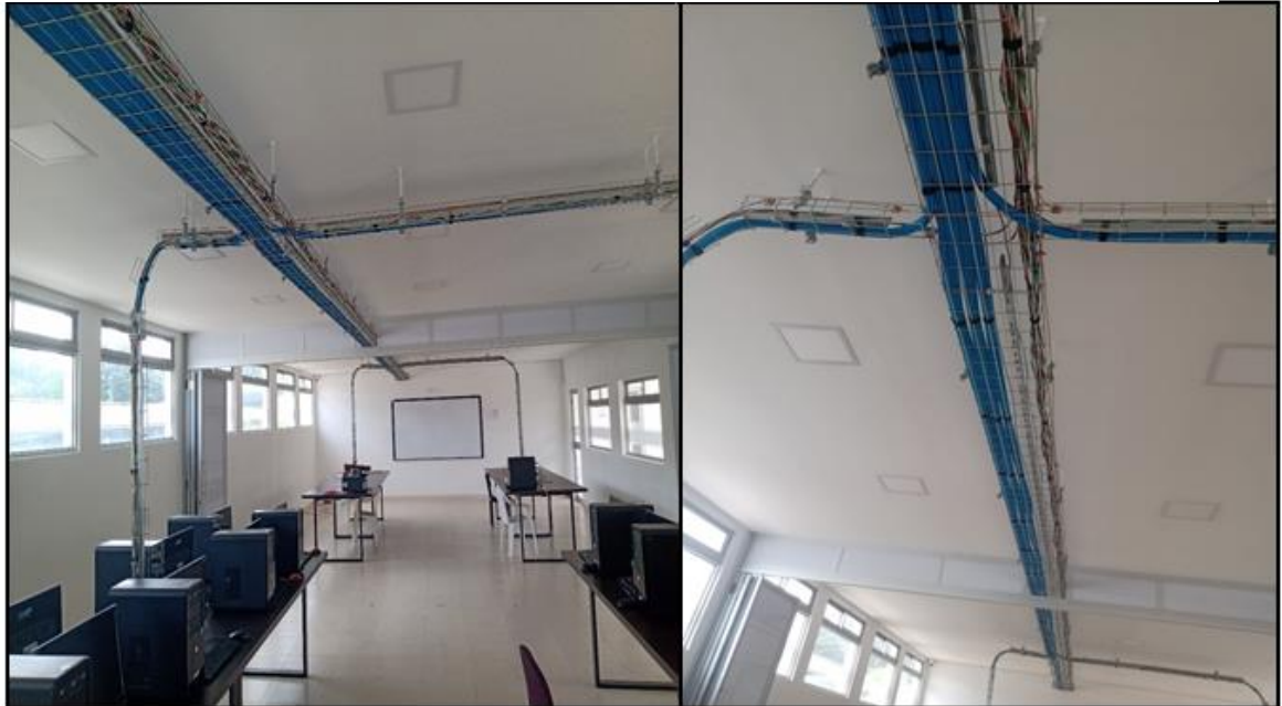
Figura 18 Cableado Horizontal Aulas MTIC Bloque de Sistemas
