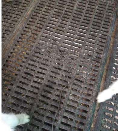
Figura 12. Condición de pisos (autor, 2019).
