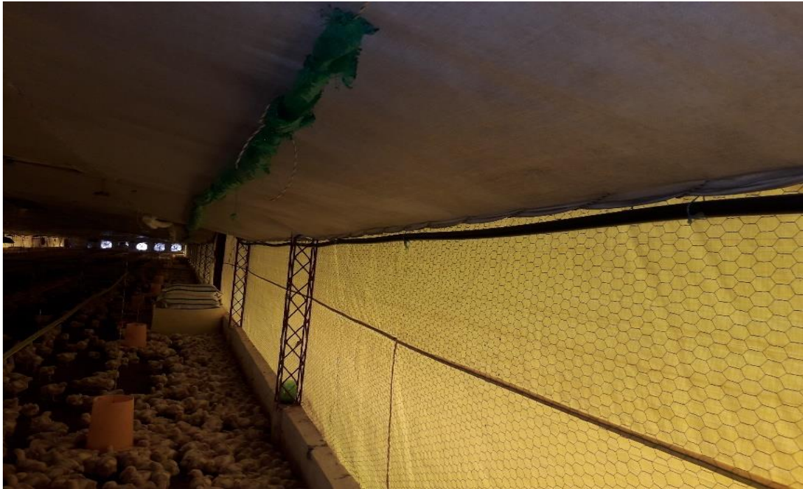
Figura 11. Malla externa que impide el ingreso de animales externos al galpón.
