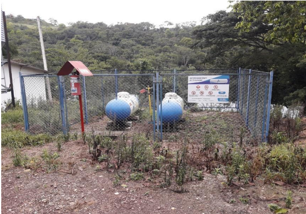
Figura 15. Tanques de gas destinados para proporcionar este a las criadoras de los galpones cinco (5) y seis (6).
