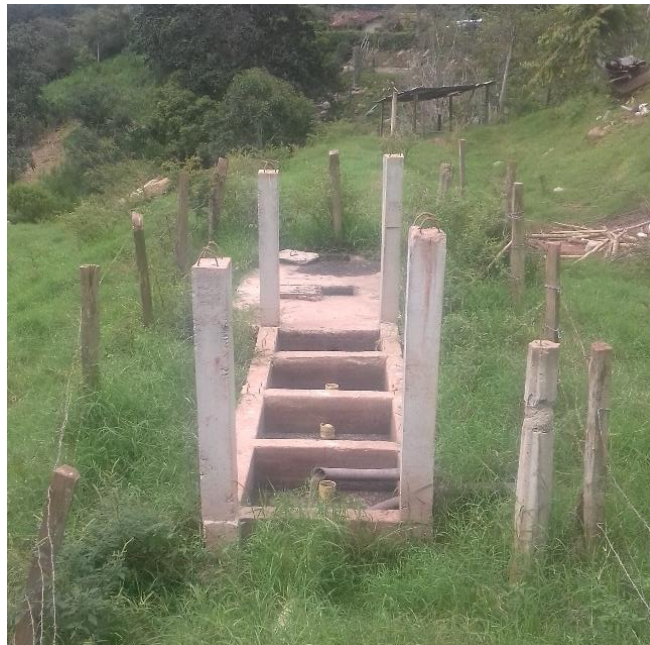
Figura 4 Tanques recolectores de aguas negras
