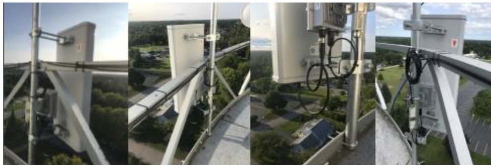
Figura 98. Ejemplo de Instalación de antenas en una torre de comunicaciones de TVWS.
