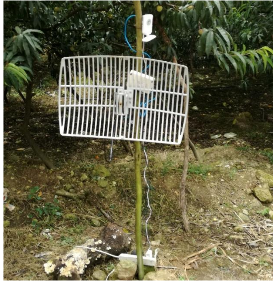
Figura 26. Ubicación antena estación con la cámara ip.
