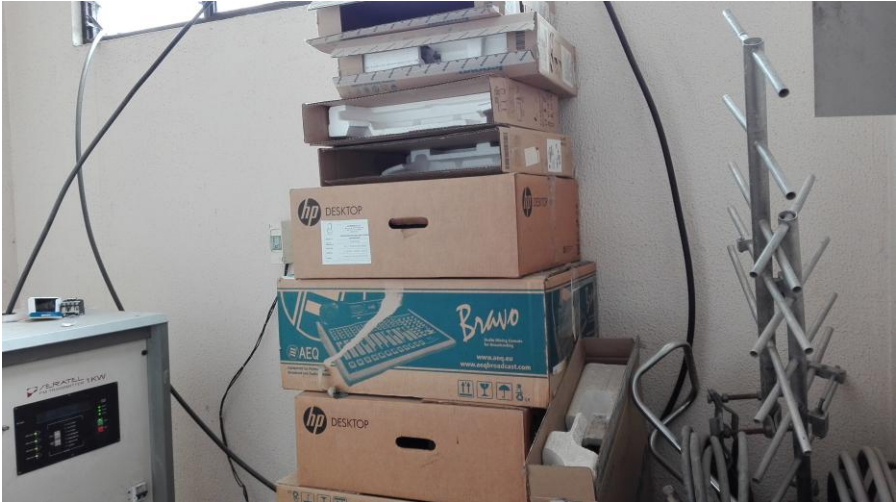
Figura 17 material que no corresponde al cuarto del transmisor
