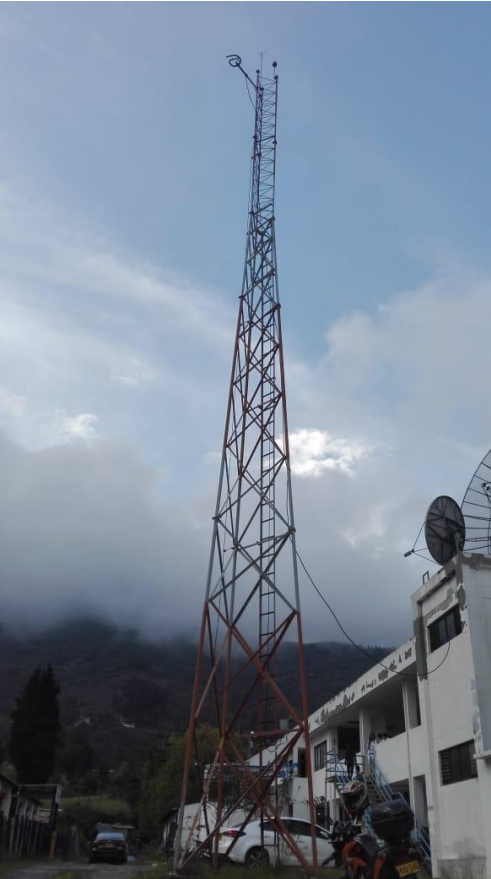
Figura 18 Torre transmisora dentro del perímetro publico
