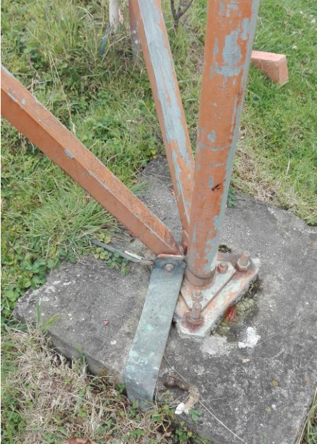
Figura 14 terminal sulfatada y estado de corrosión
