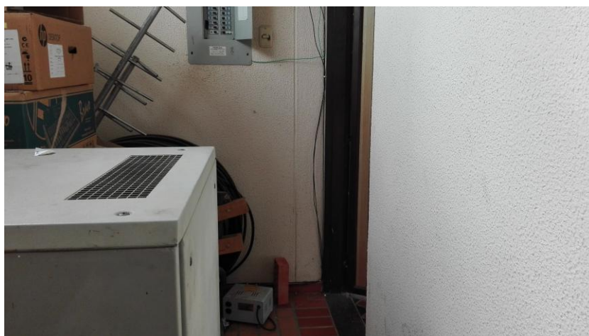
Figura 16 cuarto sin señalización
