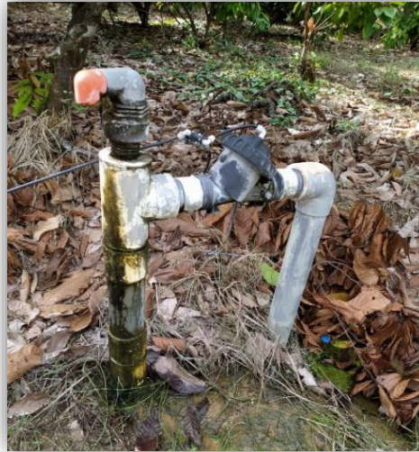
Figura 6. Válvulas o hidrantes en campo. Hacienda Maquencal.
