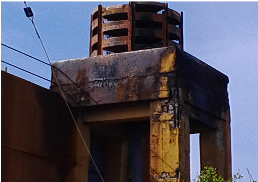
Grietas y falta de pintado de la planta
