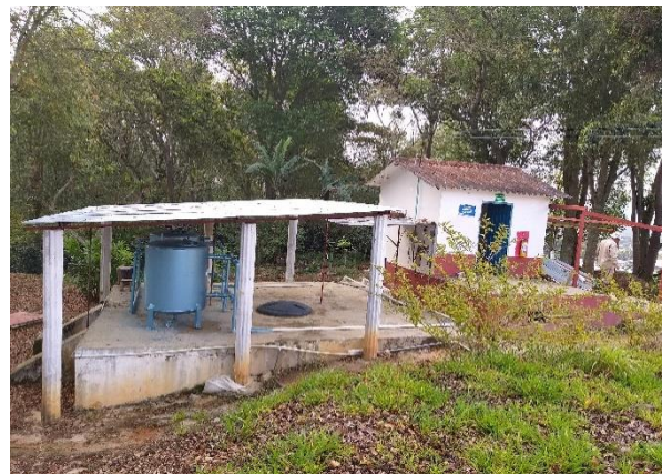
Figura 7. Planta de tratamiento del agua.
