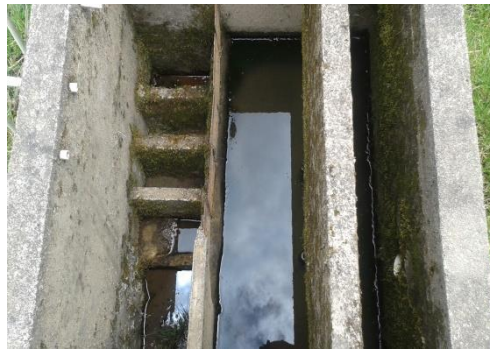
Figura 12. Tanque de distribución 1 del distrito de riego. Fuente: Archivo personal.
