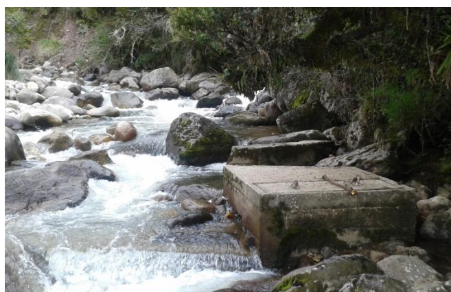
Figura 4. Captación distrito de riego ASOLAGUNA
