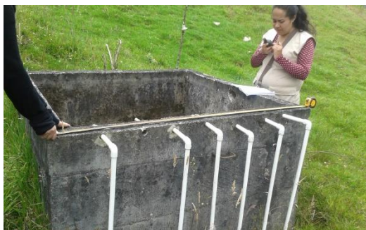
Figura 10. Tanque de distribución, distrito de riego ASOLAGUNA
