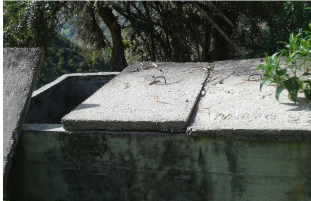
Figura 16. Tanque de distribución 5 del distrito de riego. Fuente: Archivo personal.
