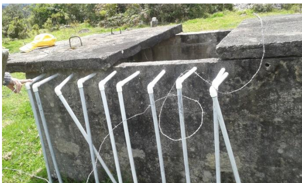
Figura 13. Tanque de distribución, distrito de riego ASOLAGUNA
