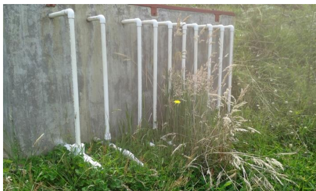
Figura 12. Tanque de distribución, distrito de riego ASOLAGUNA
