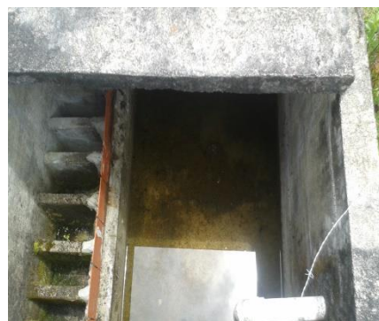
Figura 14. Tanque de distribución, distrito de riego ASOLAGUNA
