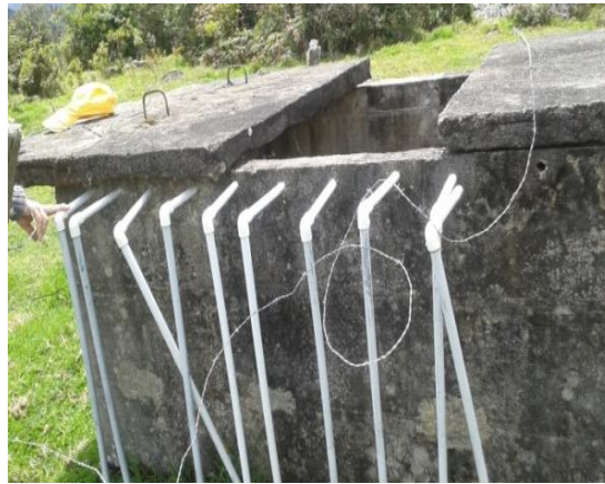
Figura 14. Tanque de distribución distrito 3 de riego. Fuente: archivo personal
