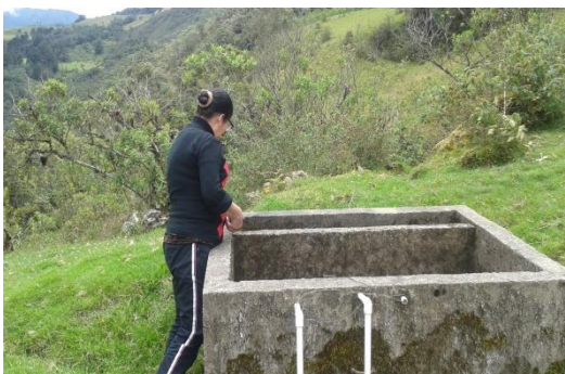
Figura 8. Tanque de distribución, distrito de riego ASOLAGUNA
