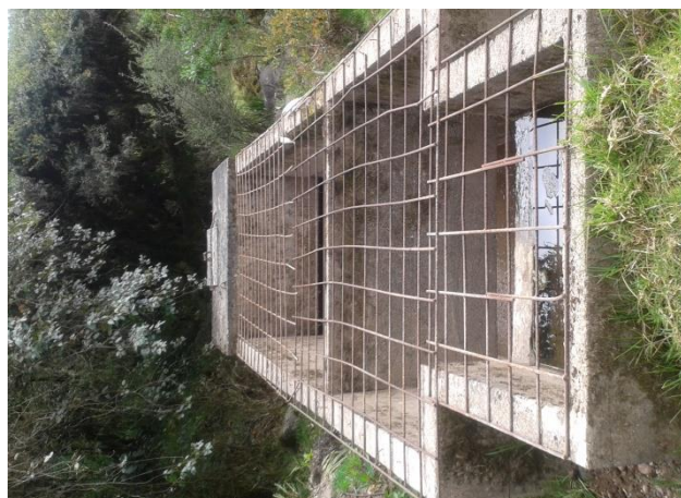
Figura 6. Desarenador distrito de riego ASOLAGUNA
