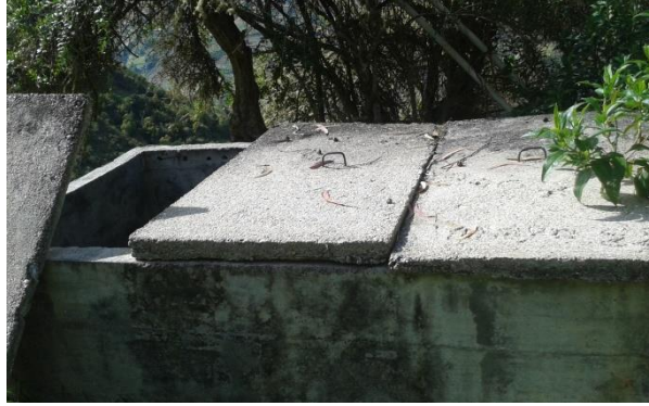
Figura 15. Tanque de distribución, distrito de riego ASOLAGUNA
