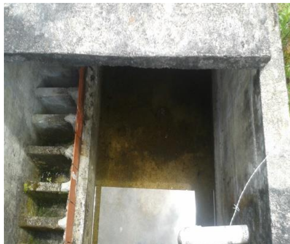
Figura 15. Tanque de distribución 4 del distrito de riego. Fuente: Archivo personal.
