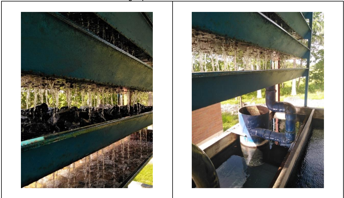
Ilustración 24. Planta de tratamiento de agua potable.
