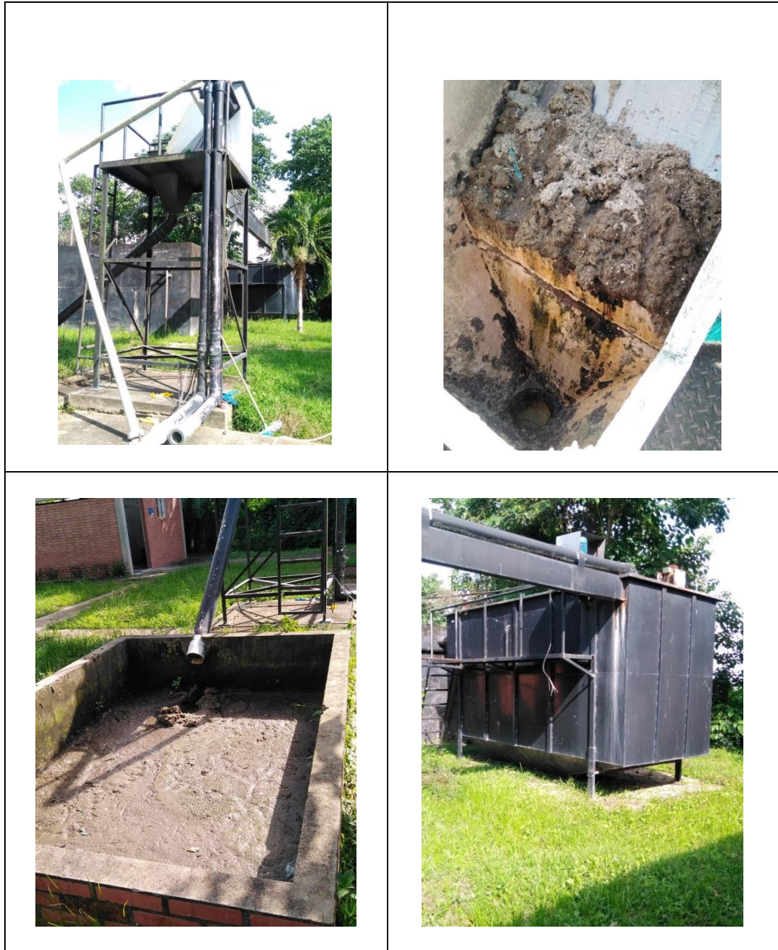
Ilustración 25. Estado actual de la PTAR
