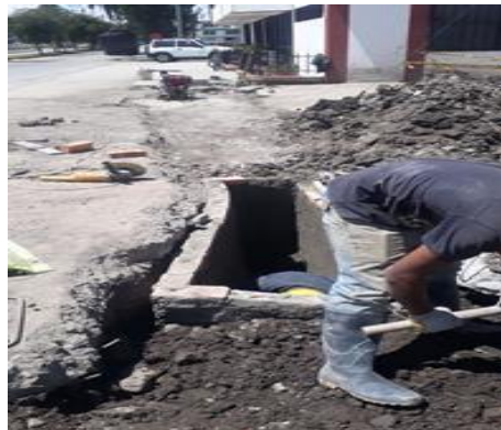
Figura 15 caja de inspección
