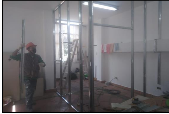
Figura 11. Perfiles de soporte muro Dry Wall
