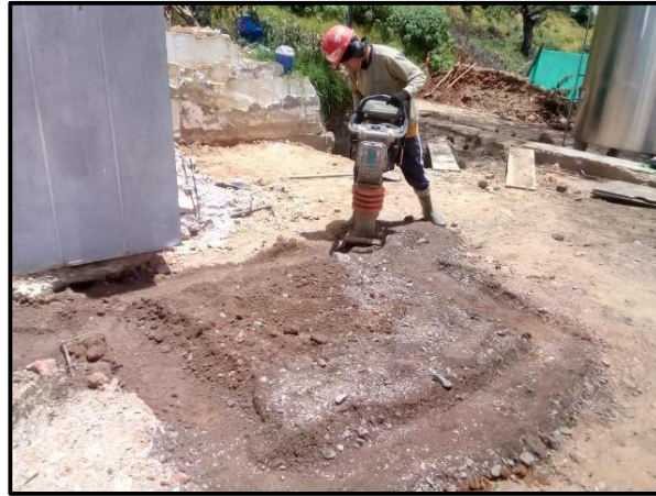
Figura 46. Relleno y compactación de excavación para cimentación errónea.
