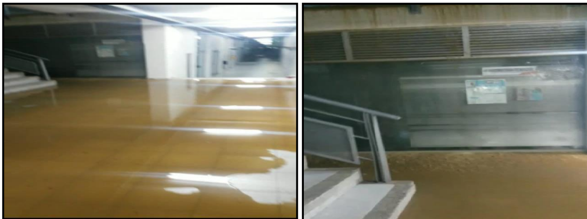
Figura 31. Inundación presentada edificio Simón Bolívar
