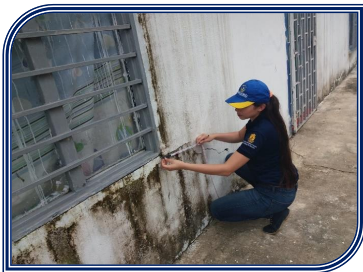
Figura 36. Manchas y Grietas debido a asentamientos diferenciales.
