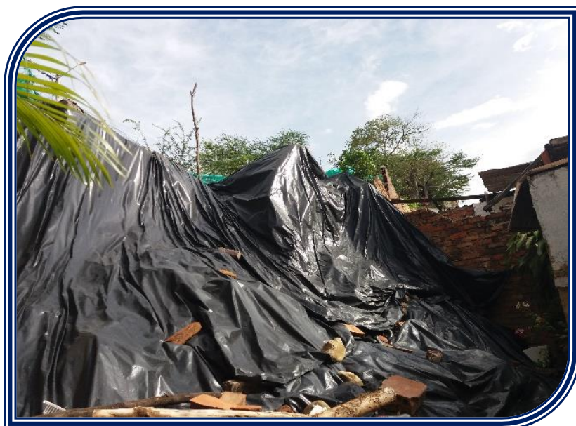
Figura 34. Talud cubierto con material plástico.
