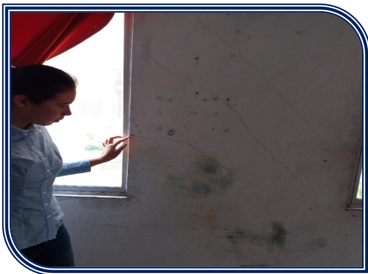
Figura 35. Fisuras por errores de diseño y detallado.
