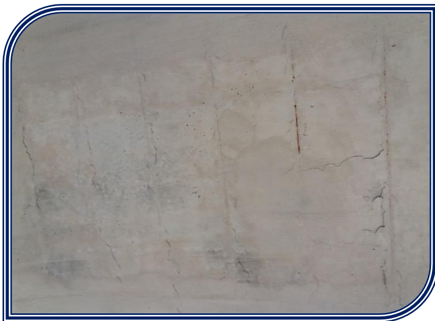
Figura 39. Corrosión de armadura en placa de entrepiso.
