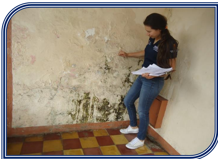
Figura 37. Humedad en muro de concreto.
