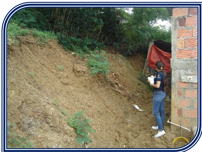
Figura 30. Edificación en la zona de material deslizado.
