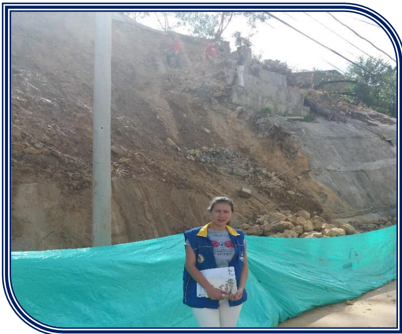
Figura 22. Deslizamiento de talud en concreto.
