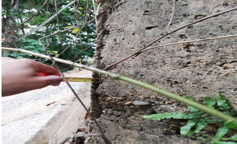
Ilustración 9. Fallo de la estructura que se pensaba recuperar del puente ubicado en la vía a la vereda el Loro (2019).
