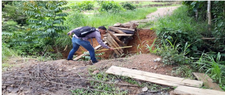
Ilustración 7. Visita de inspección a Box Couvert desplomado, que conduce a la vereda el Loro en la zona rural del municipio de Tierralta, Fuente: Practicante (2019).
