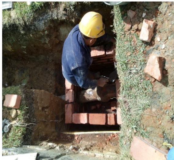
Ilustración 10. Caja para conexión de Tubería Sanitaria.
