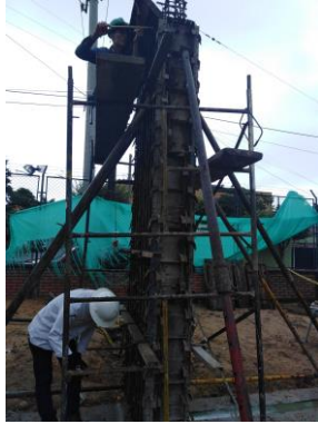
Revisión de plomo de la columna de para garantizar que ha quedado en la posición exacta definitivamente.
