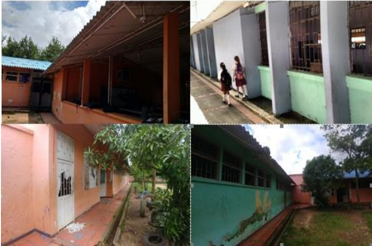
Figura 1. Estado de las instalaciones, Estudio Previos
