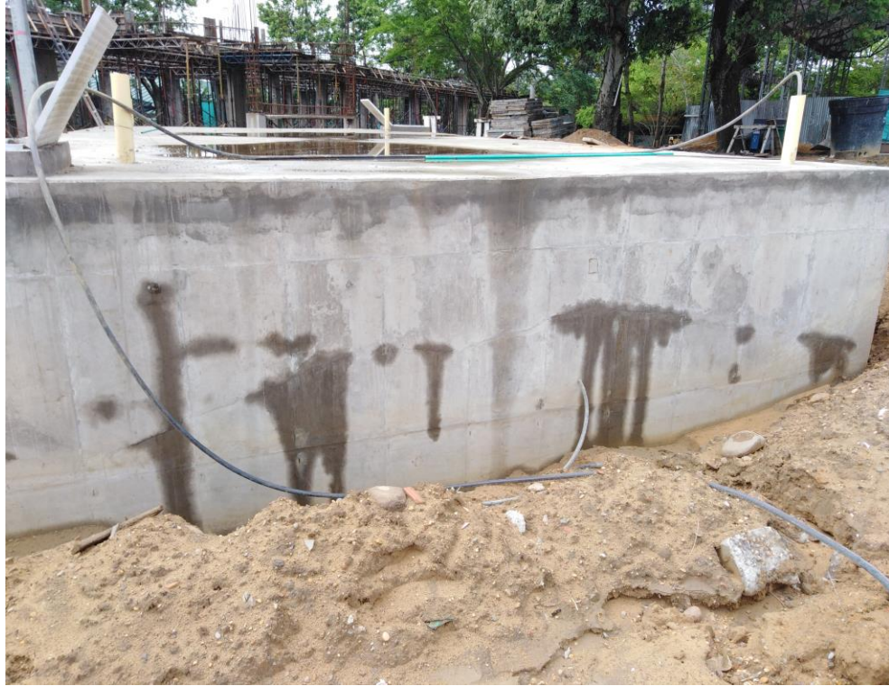
Figura 29. Filtraciones tanque subterráneo
