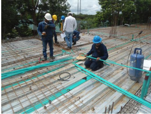
Localización de puntos de red eléctrica en placa de entre piso
