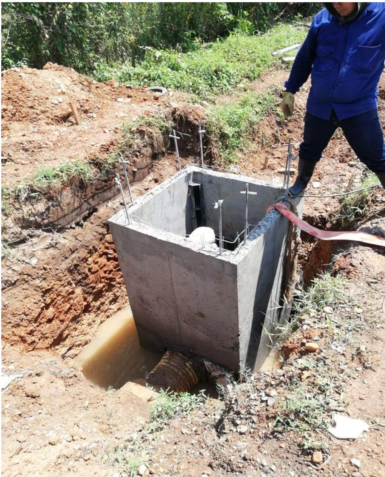
Ilustración 21. Pozo de inspección red de alcantarillado pluvial.
