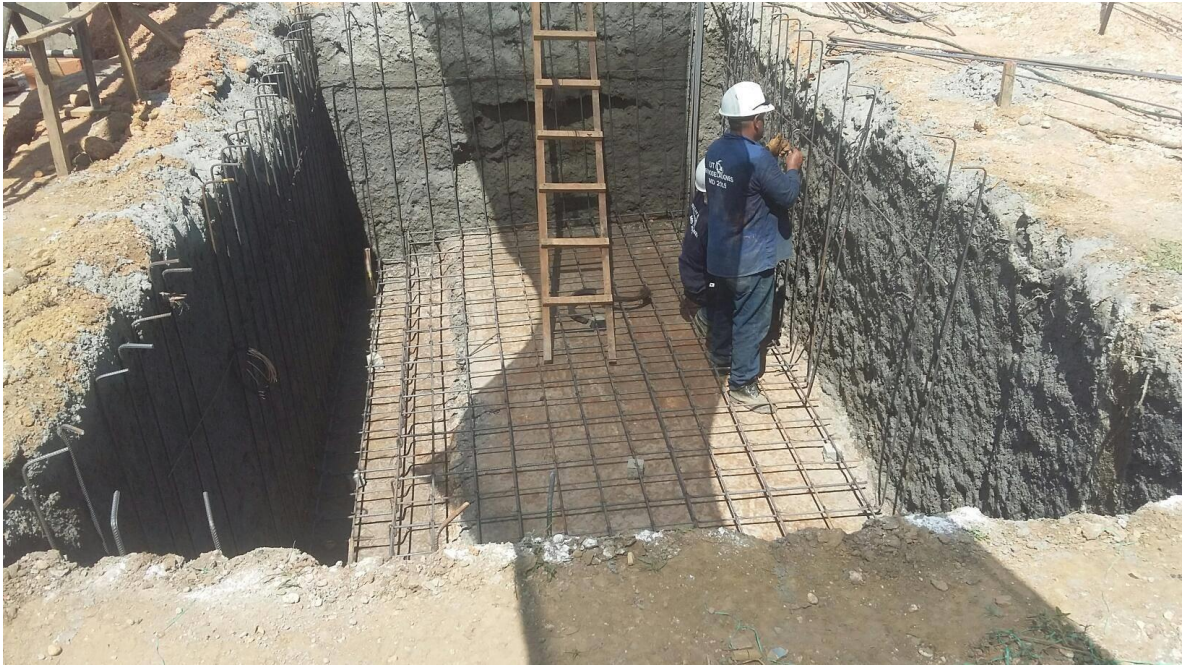
Ilustración 24. Tanque subterráneo de almacenamiento de agua potable, estadio de Puerto Wilches.
