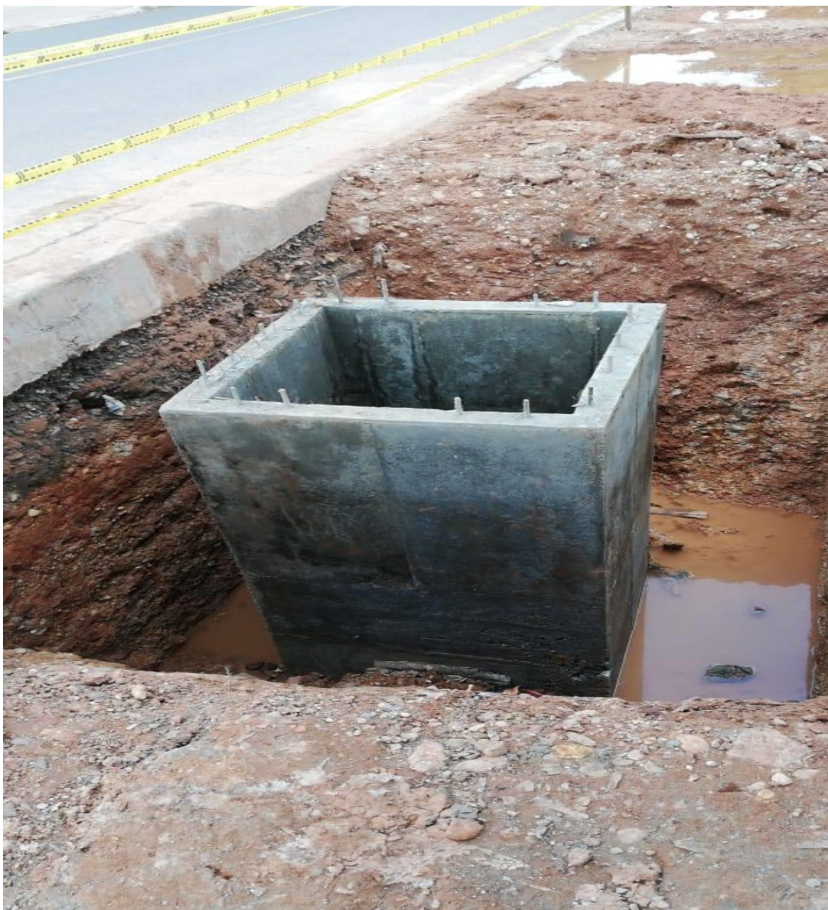
Ilustración 43 pozo de inspección perteneciente a la red de alcantarillado pluvial proyecto de remodelación estadio de Puerto Wilches
