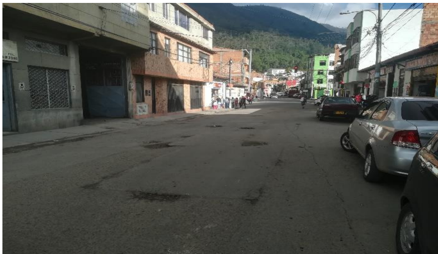
Figura 26. Estado actual de la intersección calle 8 con carrera 8, acceso Norte.
