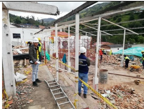
Ilustración 45. Verificación a todos los trabajadores del buen uso de los implementos de seguridad.
