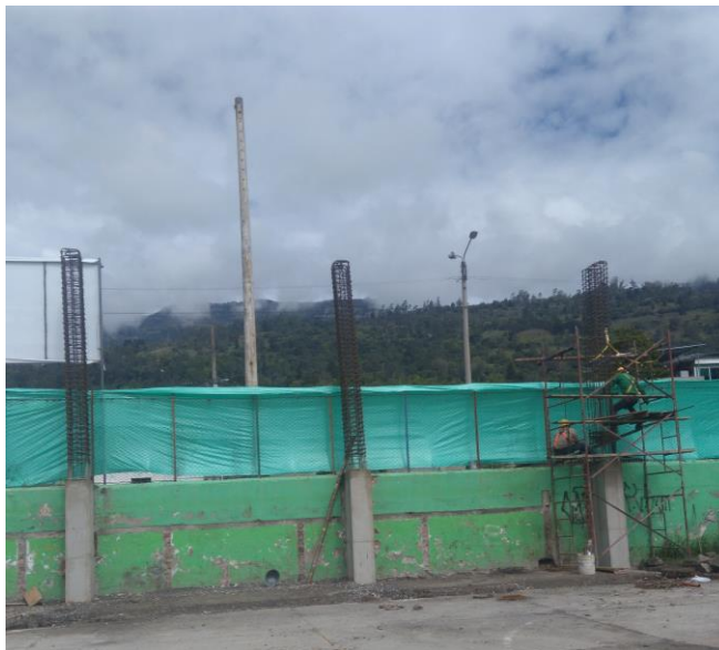
Ilustración 25 armado de acero altura faltante
