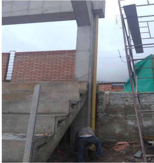
Ilustración 89 bajantes tubería de 4"
