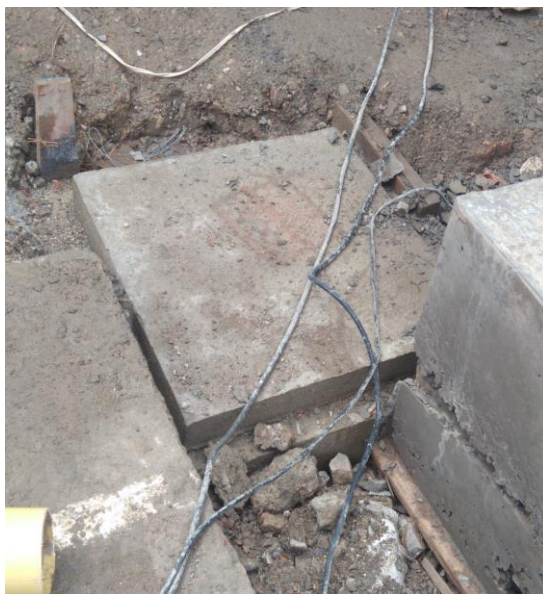
Ilustración 94 tapa caja de inspección
