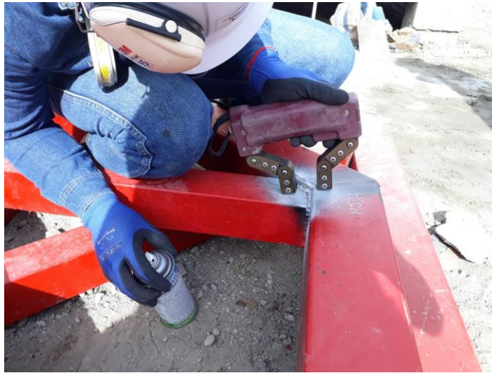
Ilustración 110 prueba de partículas magnéticas a estructura metálica
