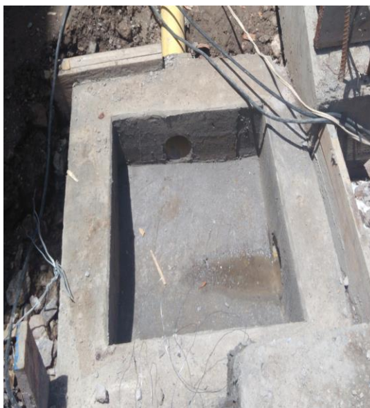
Ilustración 95 caja de inspección
