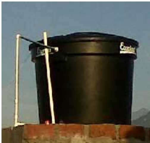
Ilustración 51 tanque de 1000Lts
