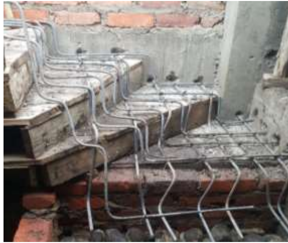
Ilustración 35 Acero de escalera
