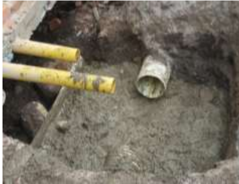
Ilustración 47 Caja de inspección
