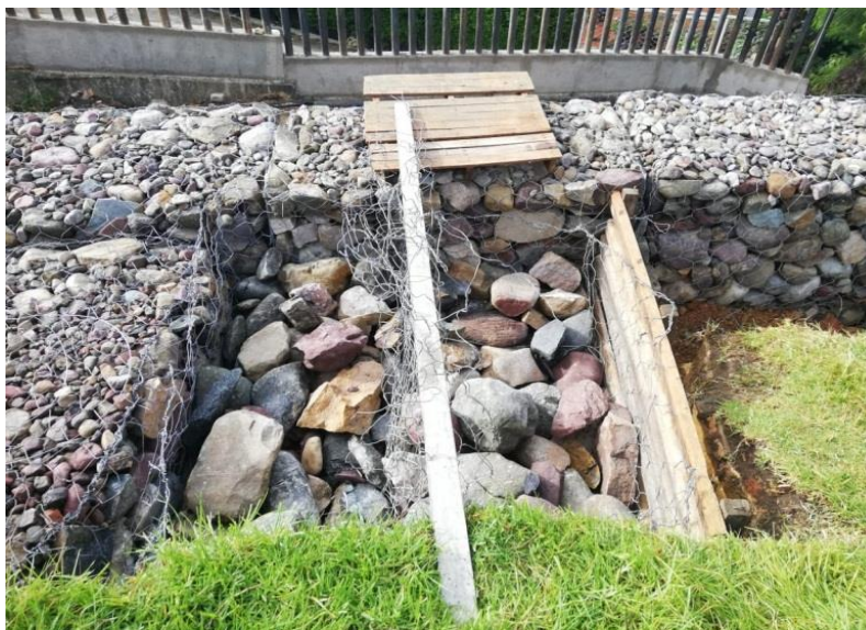
Ilustración 24. Muro en gaviones.
