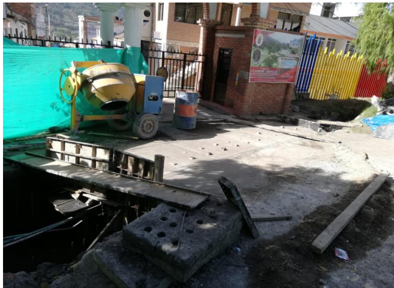
Ilustración 32. Construcción de disipador de energía para la conducción del agua lluvia y desagües del campus principal de la Universidad de Pamplona.
