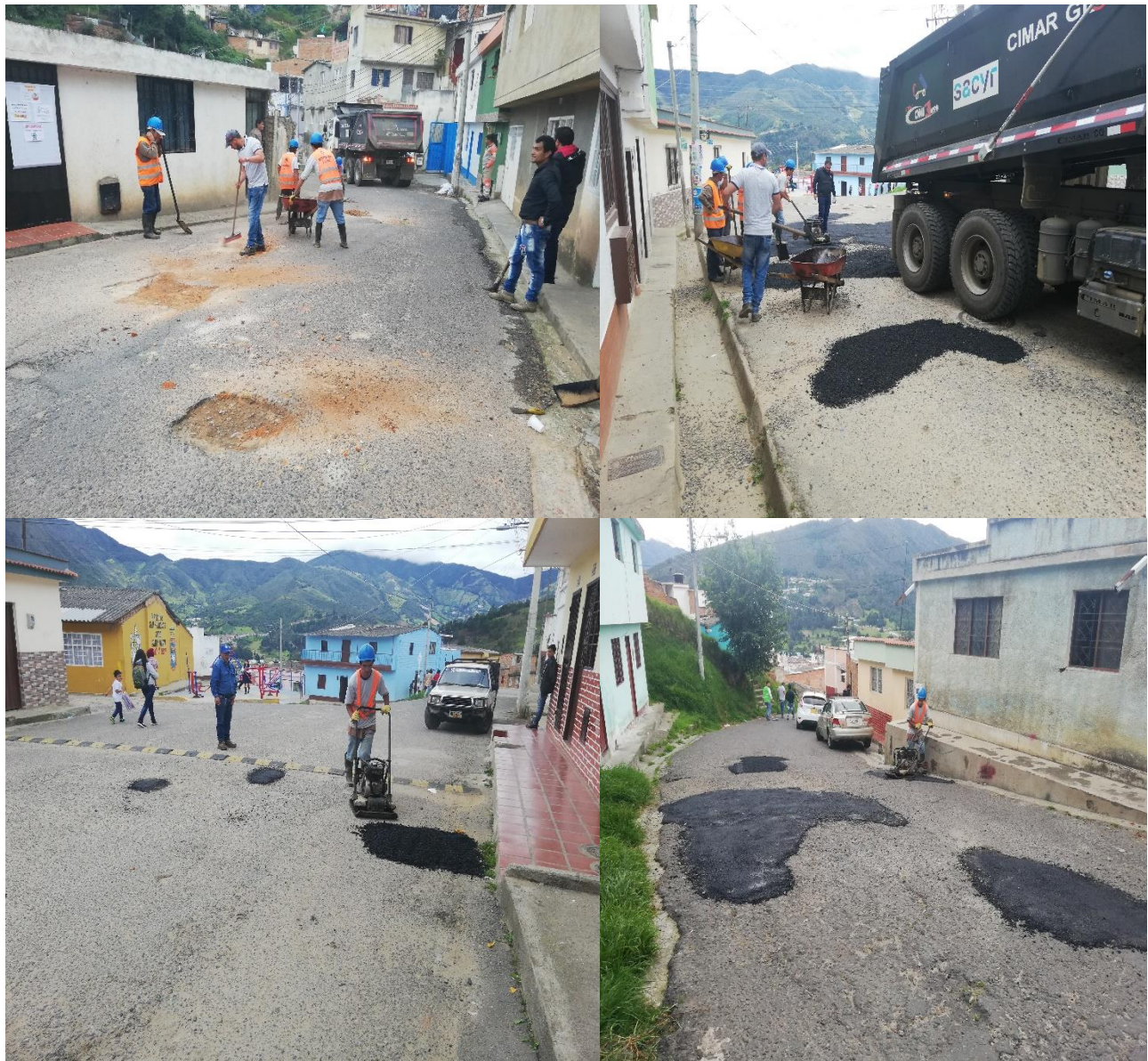
Ilustración 66. Apoyo técnico reparacheo barrio santa marta
