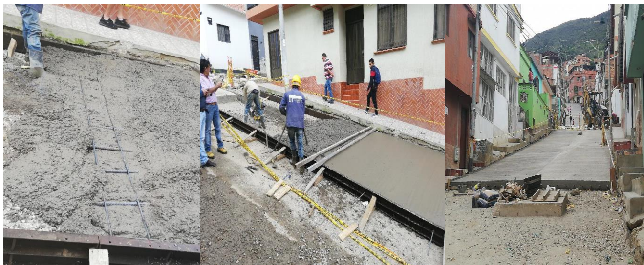
Ilustración 45. Evidencia acero corrugado.
