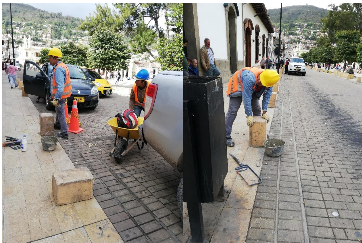
Ilustración 52. Registro fotográfico mantenimiento de bolardos
