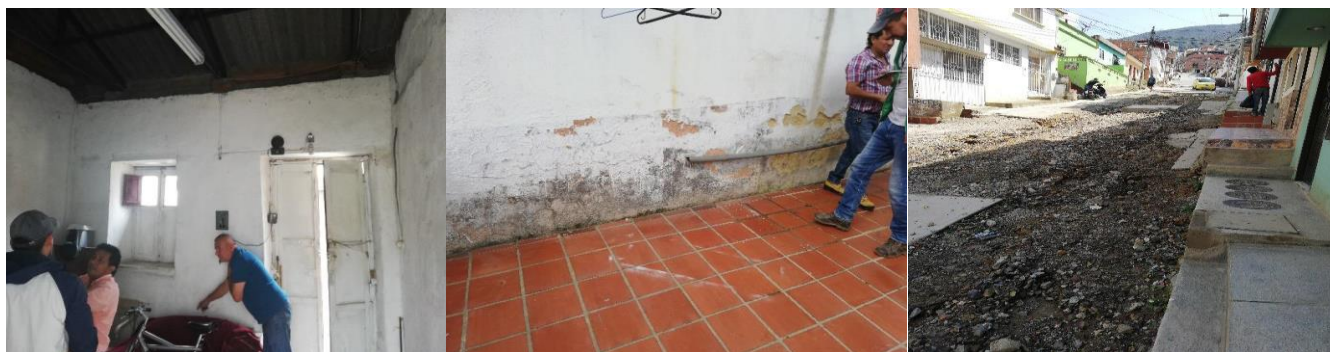
Ilustración 40. Visitas de campo estado de la vía antes de la pavimentación
