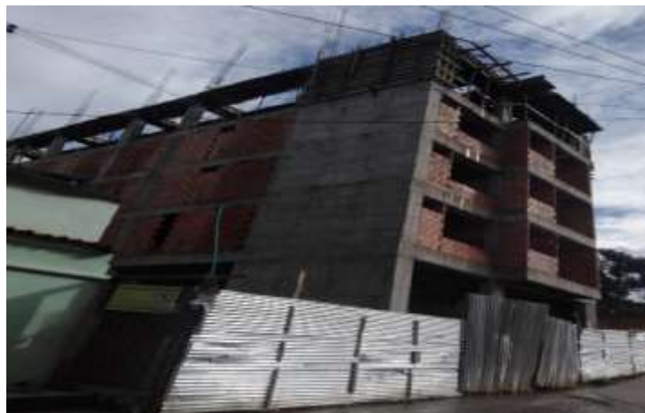
Figura 18. Estado de la obra al finalizar la práctica profesional. (Fotografía tomada en modo panorámica)
