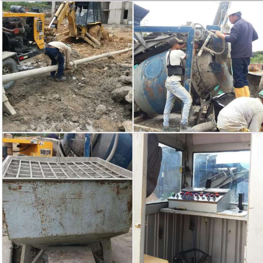
Ilustración 4. Bomba, planta, tolvas, centro de despacho.
