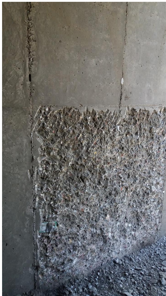
Ilustración 10. Muestra de pared afectada debido a la mala colocación de las formaletas.
