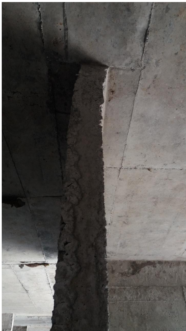
Ilustración 9. Muro interior que presenta desviación y agrietamiento.
