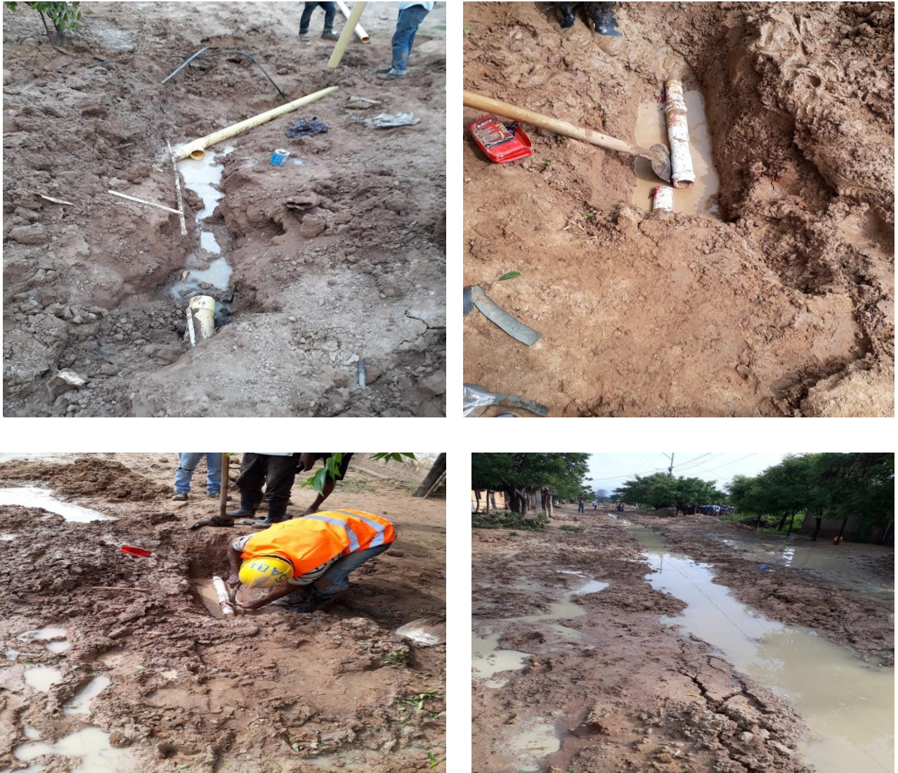
Figura 13. Reparaciones de tubería red hidráulica y condiciones del clima. Fuente: Autor (J Mena).
